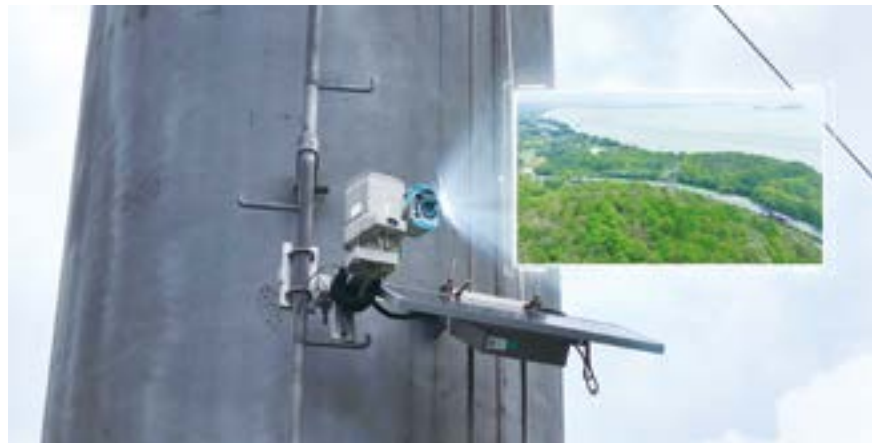
无锡水域输电杆塔视频监控设备
